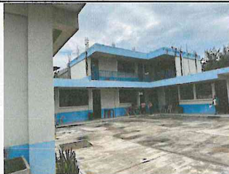
Foto 2: Pintura en muros internos y externos, presenta decoloración y desprendimiento de las paredes
