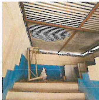
Foto 4: cambio de estructura portante de metal, ya que se encuentra llena de óxido y corrosión
